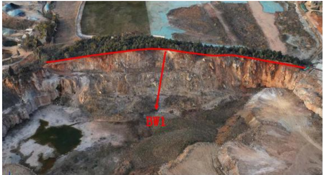
照片 3-1 BW 1 潜在不稳定边坡
